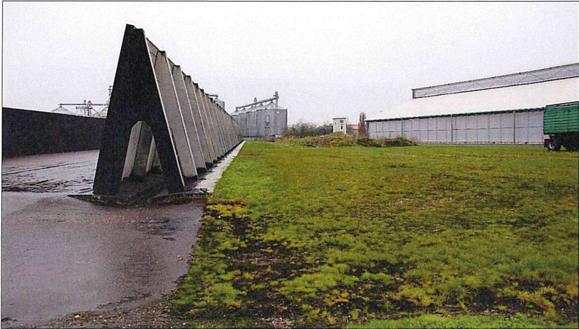
Ostbereich des PR, Blick nach Süden. Da dieses Areal als Stellplatz dient und dem Sickerwasser aus dem benachbarten Silo ausgesetzt ist, weist der Scherrasen hier Narbenschäden auf.
